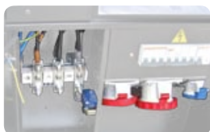
Распределительная панель с силовыми розетками и щитом шинных соединений
