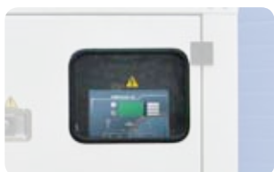
Смотровое окно для контроля параметров генераторной установки на панели управления
