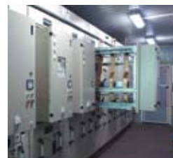
Вводно-распределительное устройство (ВРУ)
