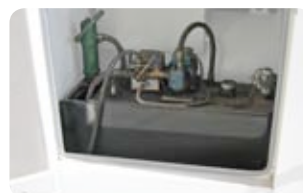
Система автоматической подкачки топлива
